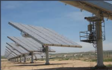
7.8MW - Parque Solares de Navarra Navarra, Spain
