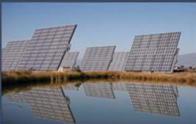
1MW - Energías del Tiétar Extremadura, Spain
